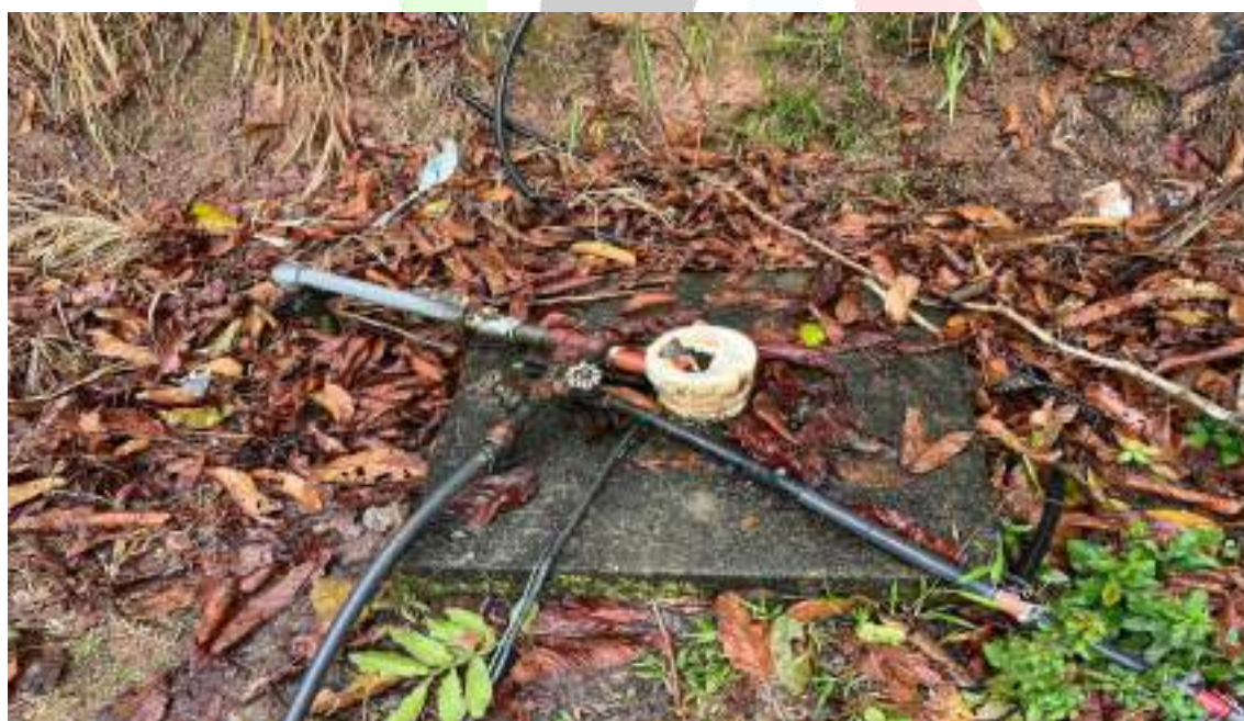
Fotografía 13. Pozo con bomba sumergible, cabecera parroquial
