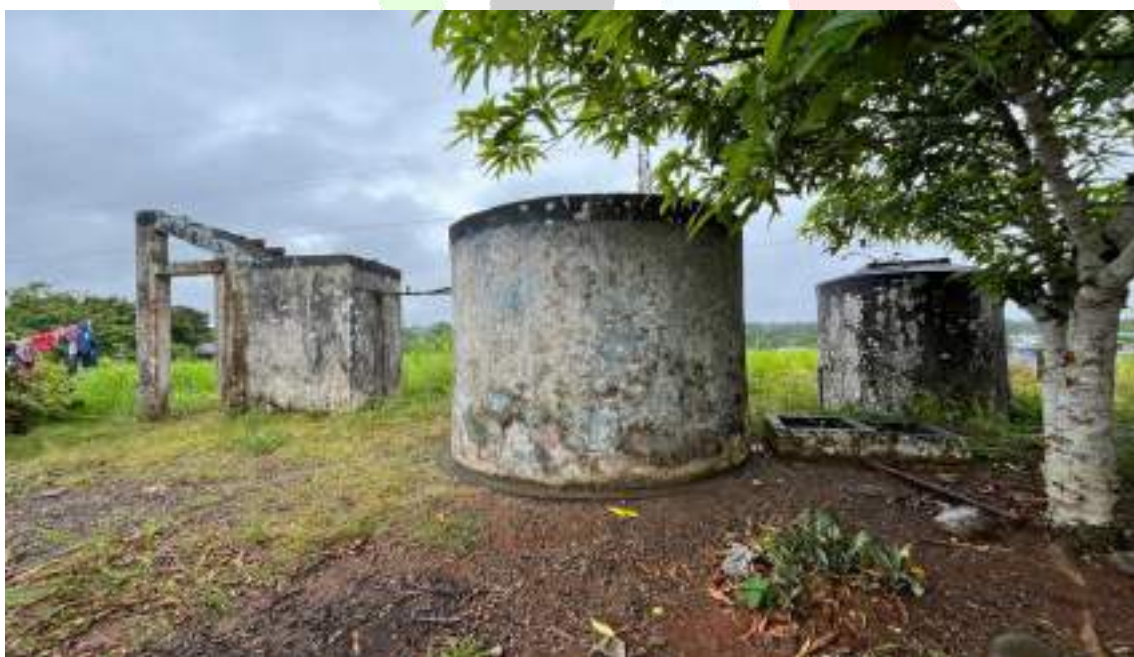
Fotografía 15. Depósitos de almacenamiento en desuso
